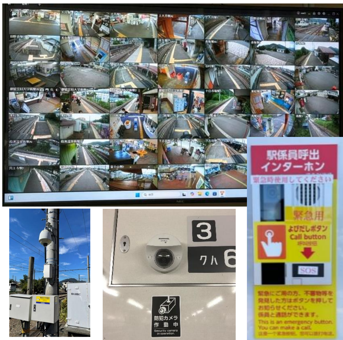
上：各駅防犯カメラモニター監視 中：車内防犯カメラ 右：駅係員呼出しインターホン
