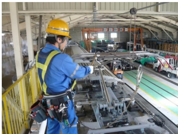
車両整備・点検
